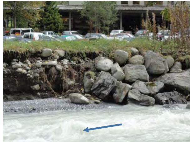
Abbildung 6: Nahaufnahme der Erosion und des Blocksatzes
