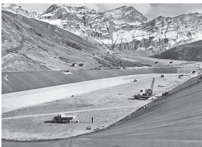
Bild 5. Die Kraftwerke Zervreila entstanden in den Jahren 1953–1958; im Bild der Bau des Ausgleichsbeckens Wanna im Safiental (Quelle: Bildarchiv Kraftwerke Zervreila).
