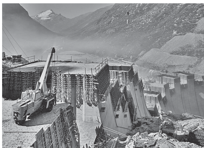
Bild 6. Die Kraftwerke Hinterrhein entstanden in den Jahren 1956–1963; im Bild der Bau des Staudamms im italienischen Valle di Lei (Quelle: Bildarchiv Kraftwerke Hinterrhein).
