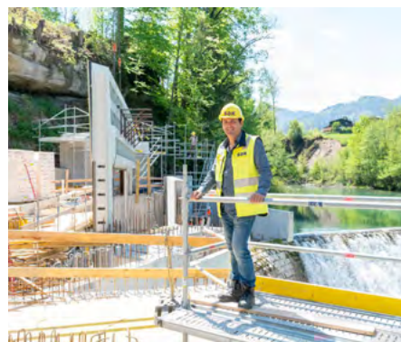
Pilotanlage zu Fischleitrechen beim Kraftwerk Herrentöbeli. Bild: sak.
